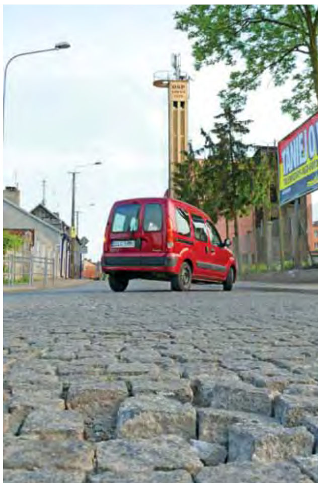
Wyrwana z nawierzchni kostka na ul. św. Floriana to widok, do którego łowiczanie już się przyzwyczaili.
