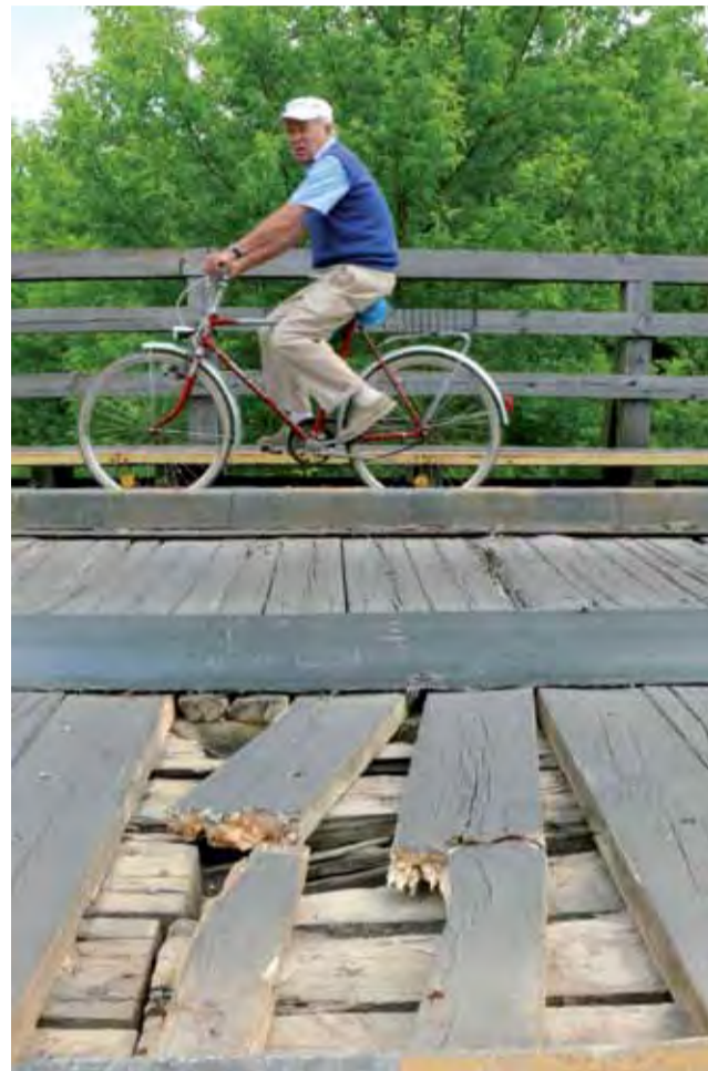
Most na Bzurze w Kompinie jest w bardzo złym stanie, widok wyrwanych desek z jego nawierzchni nie należy do rzadkości. Dziury są na bieżąco łatanie, ale ciągle ich przybywa.
