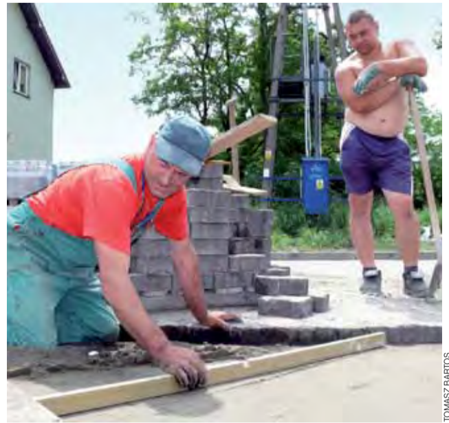
Pracownicy Zakładu Usług Komunalnych już przed Bożym Ciałem wykonali pierwszy fragment nawierzchni, w środę układali kostkę na połączeniu z ul. Jordana.
