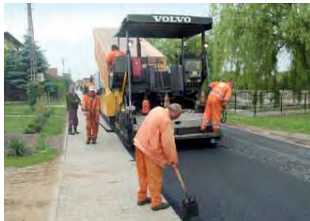
Prace wykonuje firma PRD z Gostynina. Remont jest przeprowadzony w ramach Narodowego Programu Przebudowy Dróg Lokalnych.
