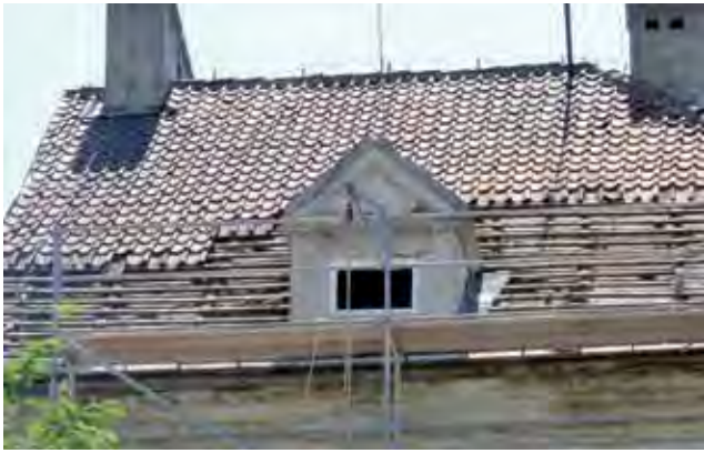
Stara dachówka wymagała wymiany. Była zniszczona, a dach w wielu miejscach przeciekał.
