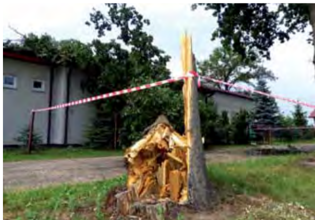
Wiatrołom w Dąbkowicach Dolnych przy szkole uszkodził rynnę.
