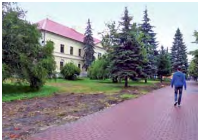
Po ogrodzeniu pozostał jedynie ślad. W tym tygodniu usunięto już podmurówkę plotu i gruz z rozbiórki.
