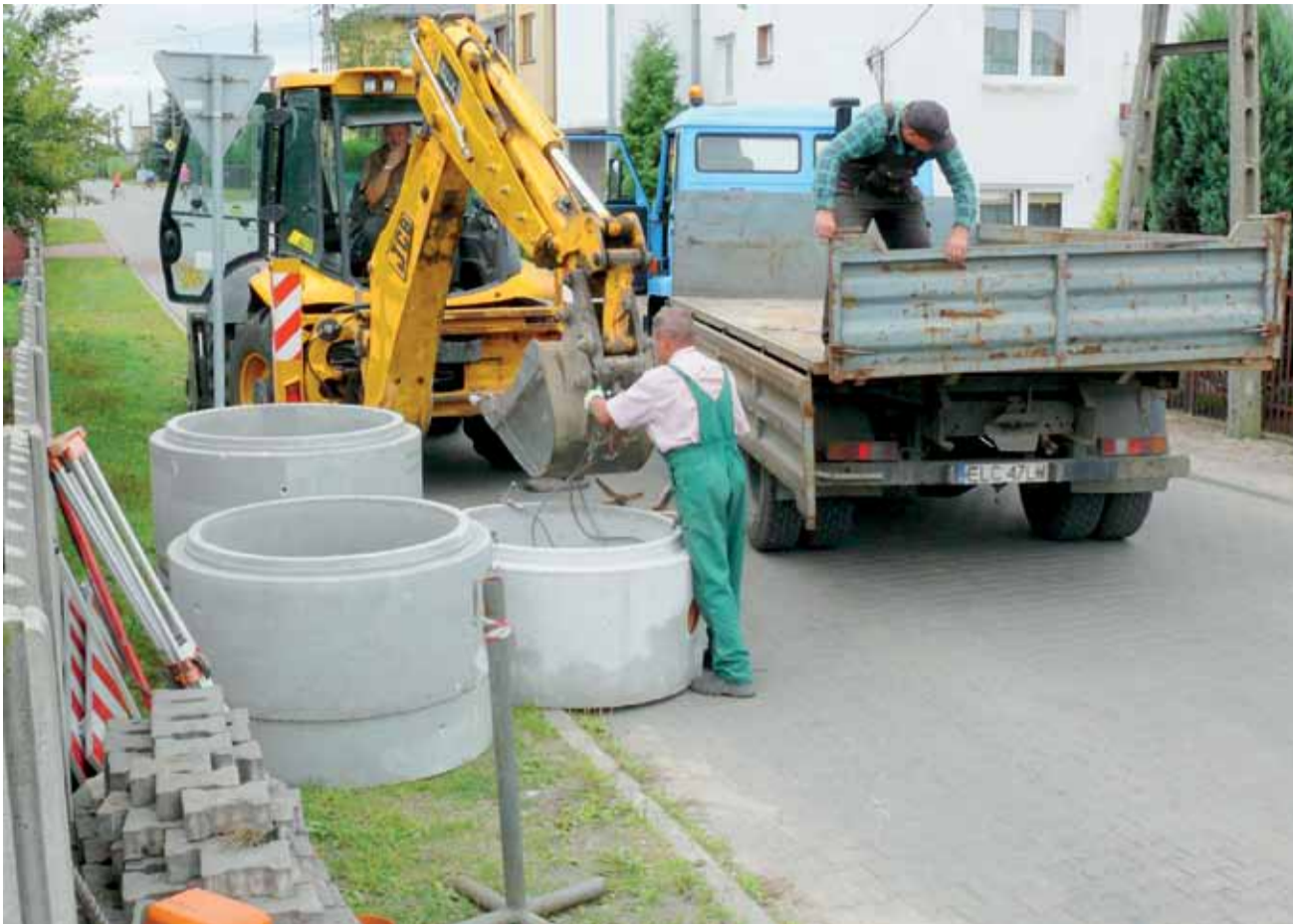
Pracownicy ZUK rozładują betonowe kręgi, które posłużą do budowy jednej ze studni nowej nitki sieci kanalizacji sanitarnej.
