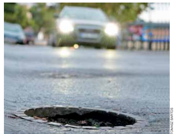
Otwór w jezdni jest niewielki i ma zostać zakryty nową pokrywą.
