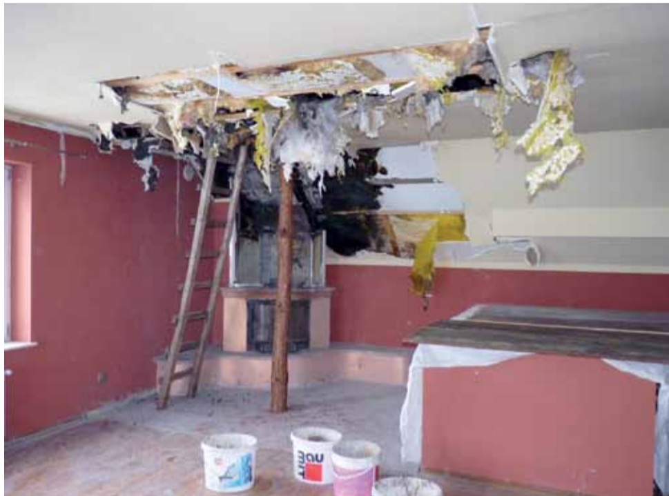
Tak, następnego dnia po zdarzeniu, wyglądało pomieszczenie, w którym wybuchł pożar.
