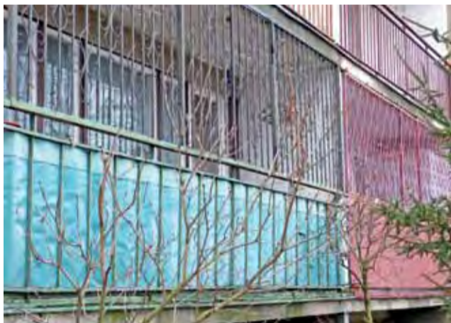
Na budynku nr 16 na Bratkowicach jest 5 zakratowanych balkonów. Na parterze tylko jeden balkon nie ma krat.
