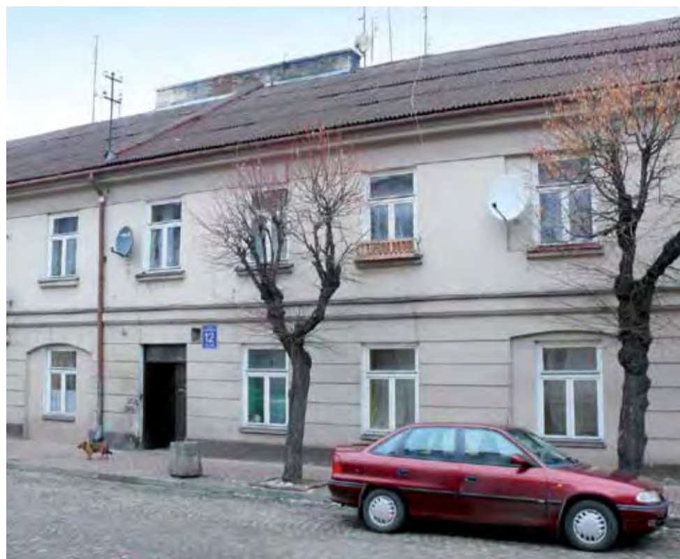
Zabytkowa kamienica przy Podrzecznej 12, pochodząca z 1900 roku, wymaga kapitalnego remontu, ale i tak na rynku nieruchomości powinna być takowym kąskiem.
