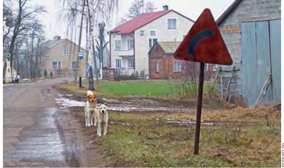
Mieszkańcy uważają, że droga w tej wsi niszczy się, ponieważ przez wysokie pobocza nie spływa z niej woda. Przy gminnej drodze stoją także znaki, które pokryły się korozją i są mało czytelne.
