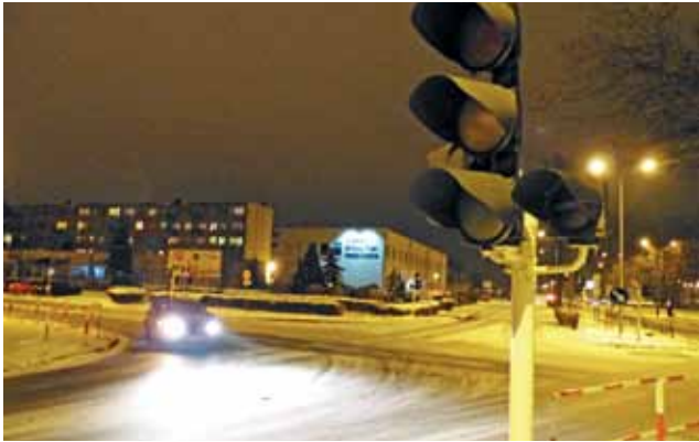
Niedziałające światła sygnalizacyjne na skrzyżowaniu ul. Sikorskiego z Kurkową były sporym utrudnieniem dla kierowców, szczególnie nocą.
