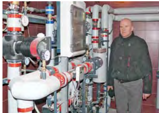
Janusz Mostowski szef firmy Budowa zaprezentował nowoczesny węzeł ciepły firmy Danfoss, dzięki któremu ciepło dotrze do mieszkań.
