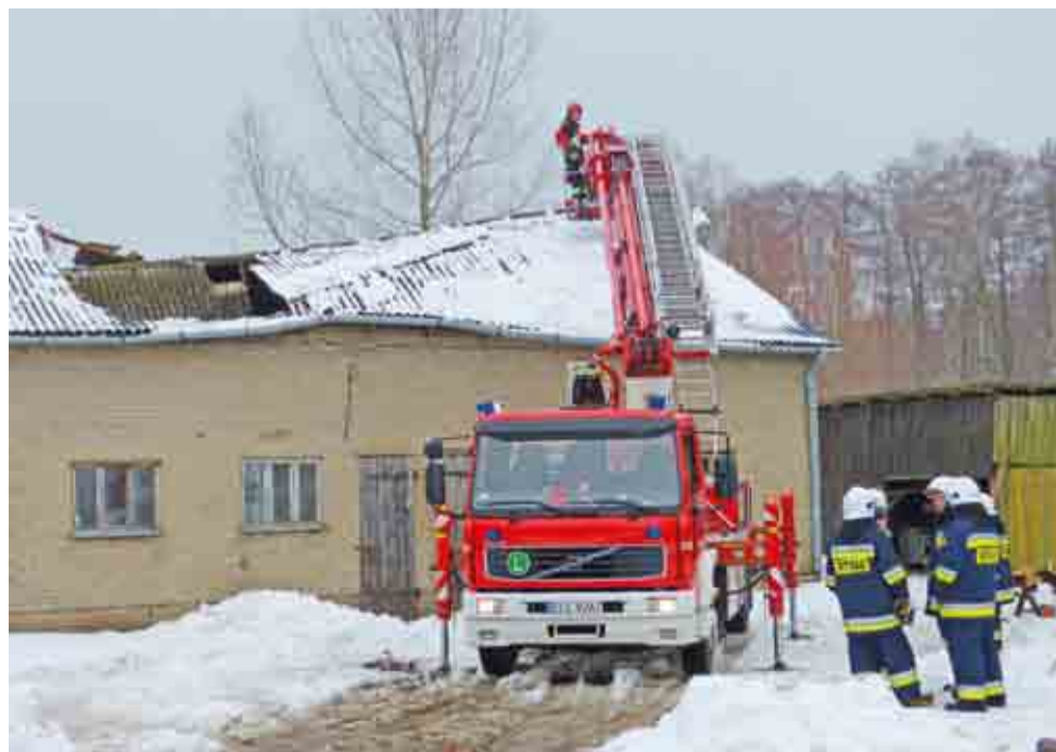
Strażacy z PSP w Łowiczu usuwają śnieg z zawalonego dachu budynku inwentarsko-składowego w Domaniewicach. Obok wozu strażackiego stoją ochotnicy z Rogóżna.
