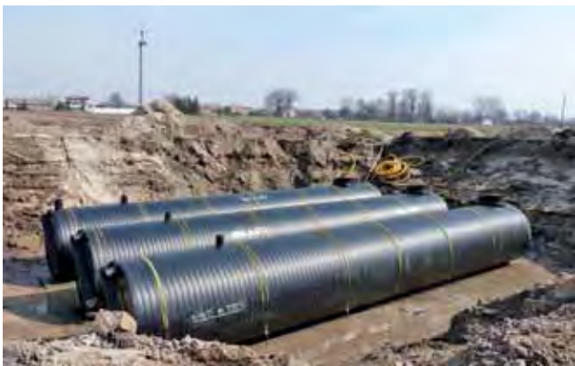
Ścieki będą gromadzone w trzech zbiornikach o objętości 25 m 3 każdy. Zbiorniki zostały przymocowane do betonowej płyty.
