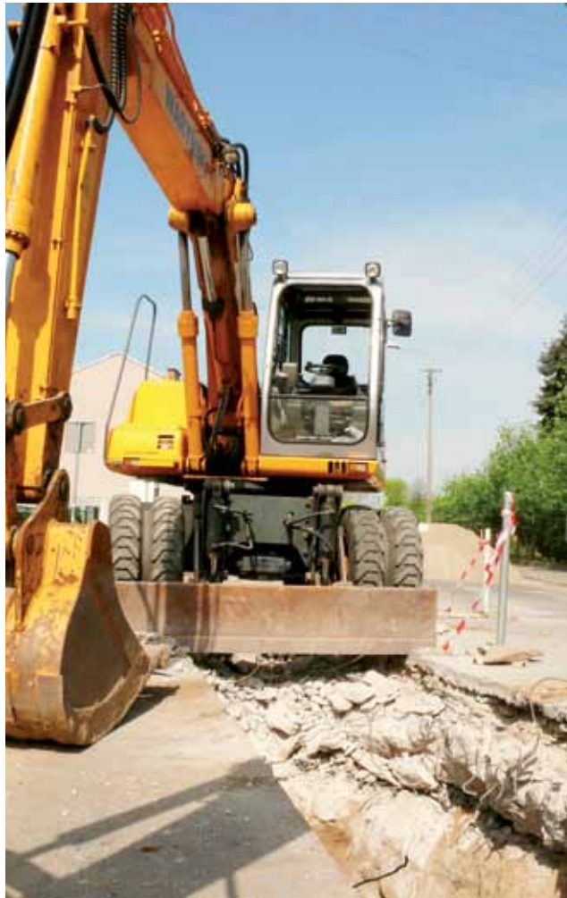
Koparka stojąca nad wykopem w miejscu skrzyżowania przy komendzie policji. Na zdjęciu dobrze widać rozbitą betonową płytę nośną mostu.
