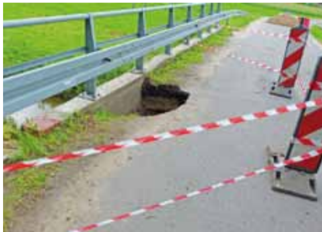
Most w Skaratkach został wyłączony z ruchu. Decyzja o jego naprawie lub odbudowie zostanie podjęta po wykonaniu ekspertyzy technicznej.
