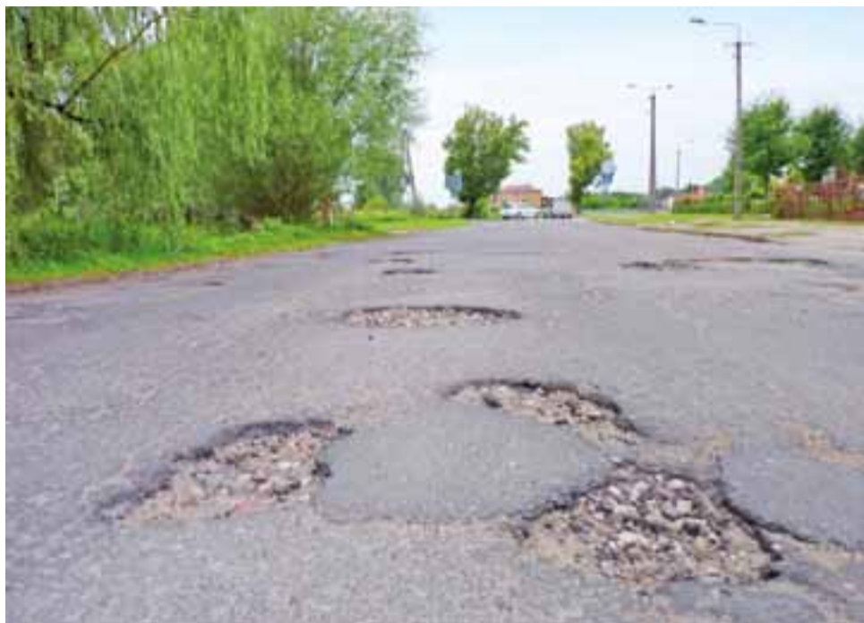
Dziury w nawierzchni głębokie na ok. 10 cm, rozsiane na całej szerokości i długości jezdni - tak wygląda ul. Legionów, ale możliwe, że jeszcze w tym roku to się zmieni.
