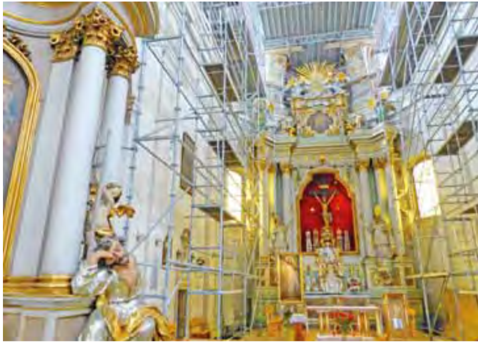
Rusztowania w kościele ojców pijarów w Łowiczu przygotowane do wykonania prac przy prezbiterium.
