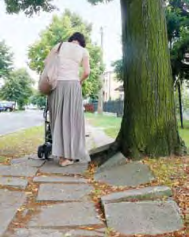
Chodnik przy ul. Żwirki i Wigury jest w kilku miejscach w fatalnym stanie – przejście po takim torze przeszkód z wózkiem to prawdziwy wyczyn.
