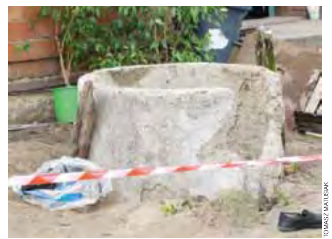
Nieużywana studnia, w której utonęła kobieta, była w fatalnym stanie i źle zabezpieczona.
