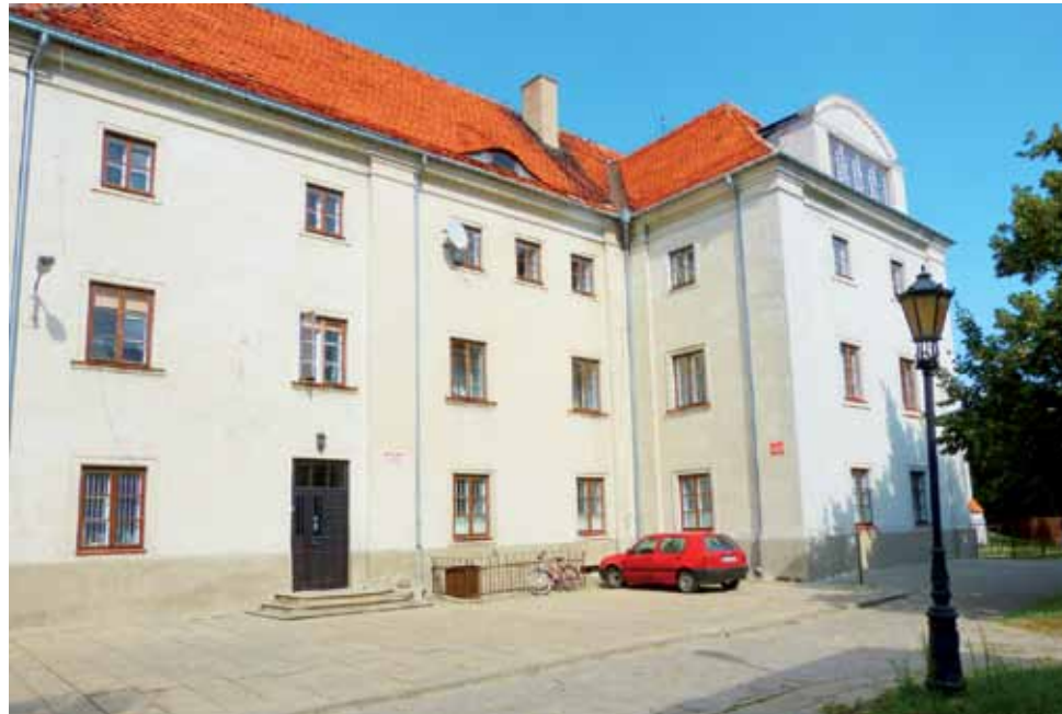
Budynek Zespołu Kolegiów Nauczycielskich w Łowiczu wymaga gruntownego remontu. Na początku ma zostać naprawiony dach.
