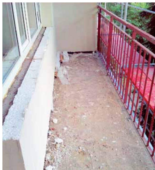
Do końca października mają czas pracownicy firmy Admar Mariusza Kuźmy i Adama Kędziory z Bobrownik w gminie Nieborów na docieplenie spółdzielczych budynków na osiedlu Bratkowice w Łowiczu. Firma wygrała przetarg za 998 tys. zł na docieplenie czterech budynków na tym osiedlu: 15, 16, 17 i 18. Roboty na pierwszym z nich już się zakończyły. Na trzech pozostałych są prowadzone jednocześnie i są na różnych etapach. mak
