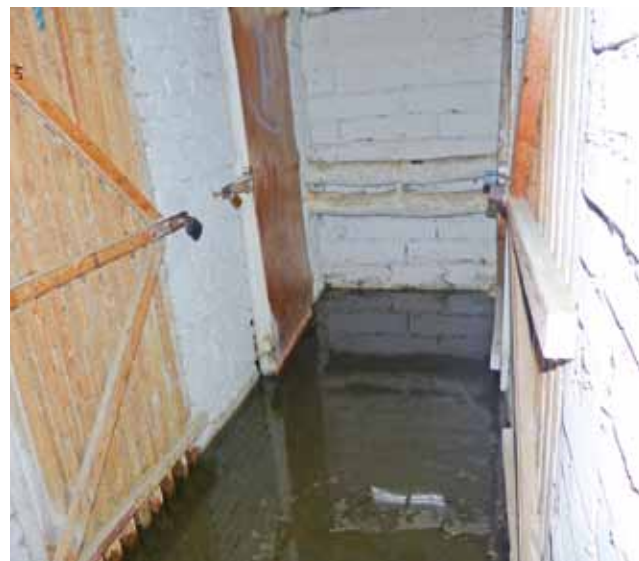
Komórki w bloku nr 4 przy os. Starzyńskiego po zalaniu wodą i nieczystościami z kanalizacji sanitarnej.
