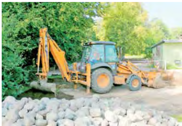
Obecnie na parkingu przed wejściem do Parku w Arkadii wykonywana jest podbudowa pod nawierzchnię. Wejście do parku jest możliwe wyznaczonym pasem wolnym od prac.
