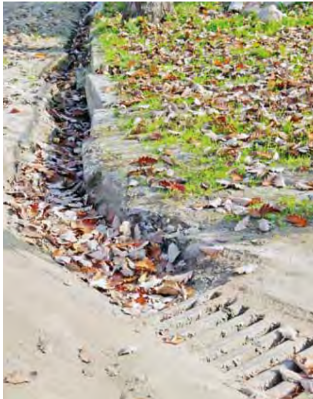
Mieszkańcy osiedla Kościuszki we własnym zakresie próbowali odprowadzać wodę z ulicy.
