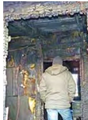
Wnętrze domu prawie doszczętnie uległo spaleniu.
