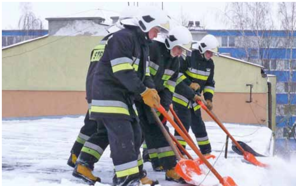
Zima dała się we znaki. Strażacy z łowickiej jednostki OSP 21 stycznia usuwali śnieg zalegający na dachach szkół i przedszkoli. Na dachu Szkoły Podstawowej nr 1 w Łowiczu zalegała 30-centymetrowa warstwa.
