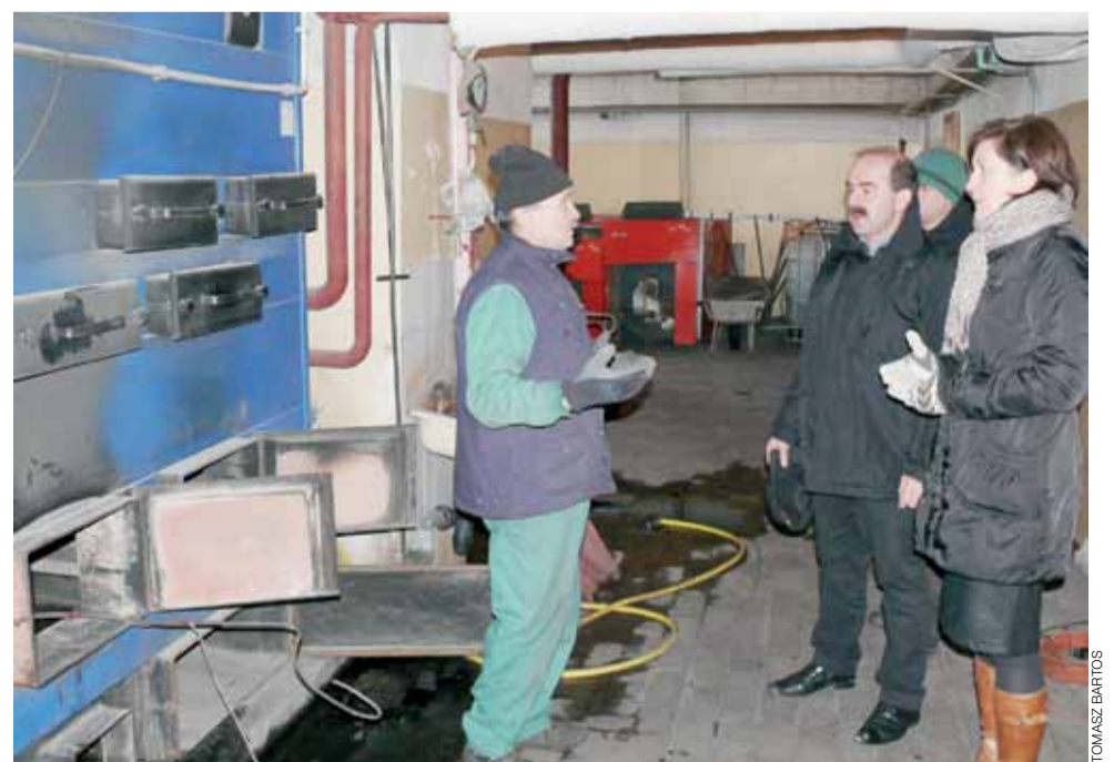
Niewielka dziura w piecu stała się przyczyną awarii, która na szczęście zostanie wkrótce usunięta.
