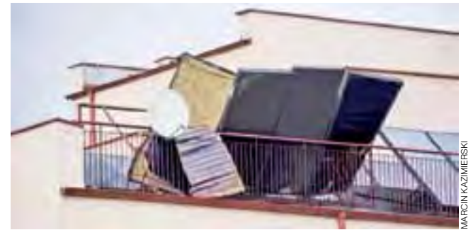
Uszkodzone solary na dachu, jeszcze przed demontażem.
