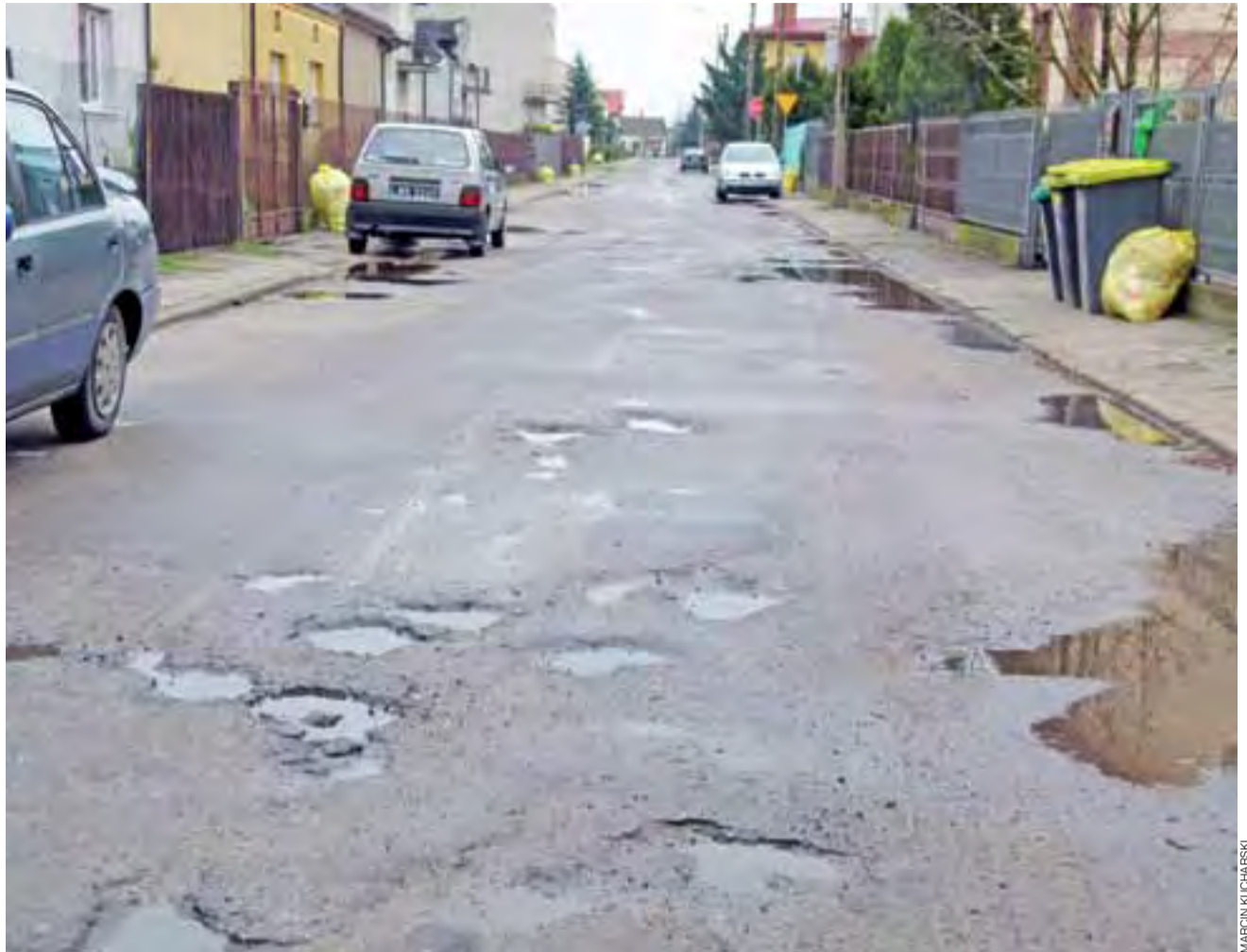
Asfalt na ul. Wygoda jest w złym stanie, co przeszkadza szczególnie po deszczach. Niektóre dziury w nawierzchni mają kilka centymetrów głębokości.
