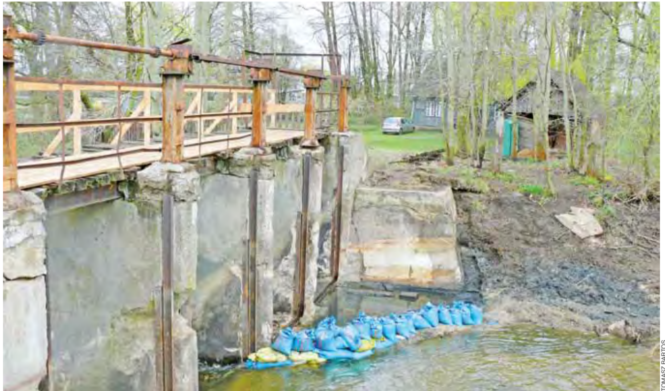
Jaz w Nieborowie, po spuszczeniu wody odsonił betonową konstrukcję, która jest w bardzo złym stanie i wymaga napraw
