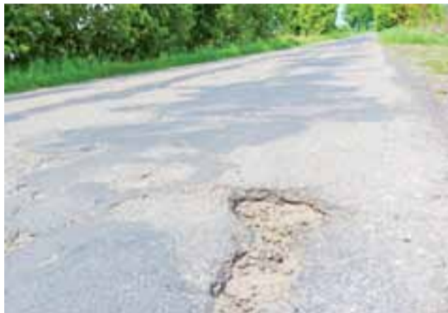
Droga powiatowa nr 5118. O ten zniszczony odcinek od granic z powiatem zgierskim do Waliszewa Starego pytał na sesji radny Dariusz Topolski.
