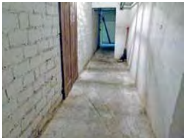
Nawet po kilku dniach po deszczu w piwnicach było wilgotno.
