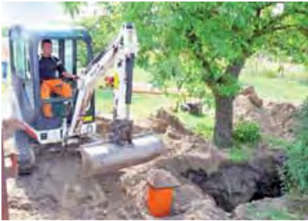
Kolektor sanitarny na ul. Łódzkiej brzezińska firma układa głównie na prywatnych posesjach, co znacząco komplikuje prace.
