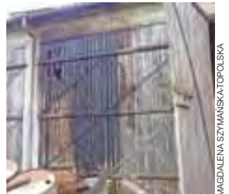
Pożar udało się ugasić, ale wrota i część dachu należy wymienić.
