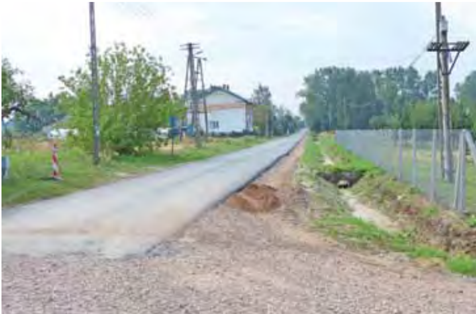
Nowa nakładka asfaltowa jest już położona na południowym odcinku drogi w Goleńsku.
