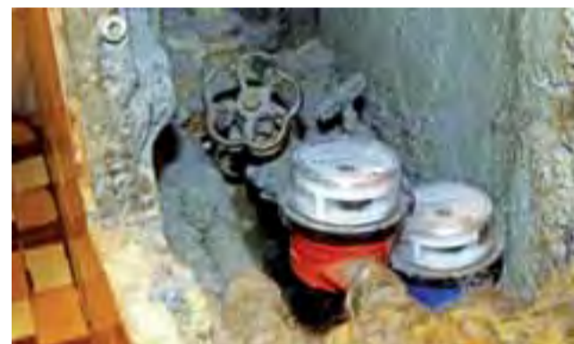
Żeby dostać się do wodomierzy trzeba w wielu mieszkaniach usunąć nawet po kilka kafelków ze ściany.
