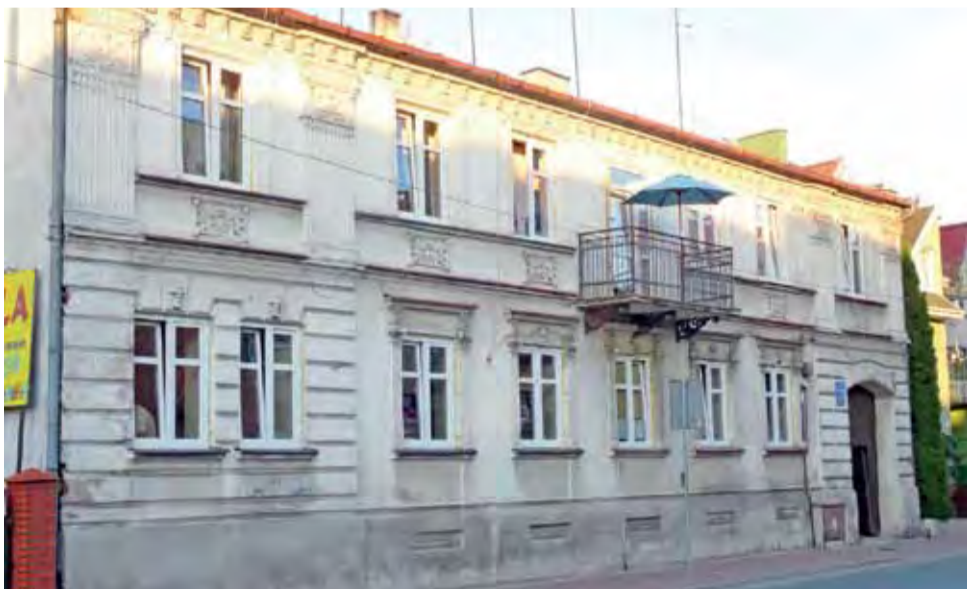
Kamienica przy ul. Długiej posiada jedną w swoim rodzaju sztukaterię na ścianie frontowej, w trakcie remontu nie tylko dach ale i one zostaną odremontowane.
