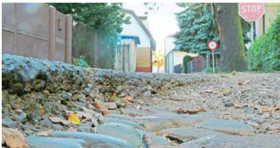
Jedna z głębokich, na kilkanaście centymetrów dziur w poboczu ul. Ciemnej, spod asfaltu widać stary bruk.
