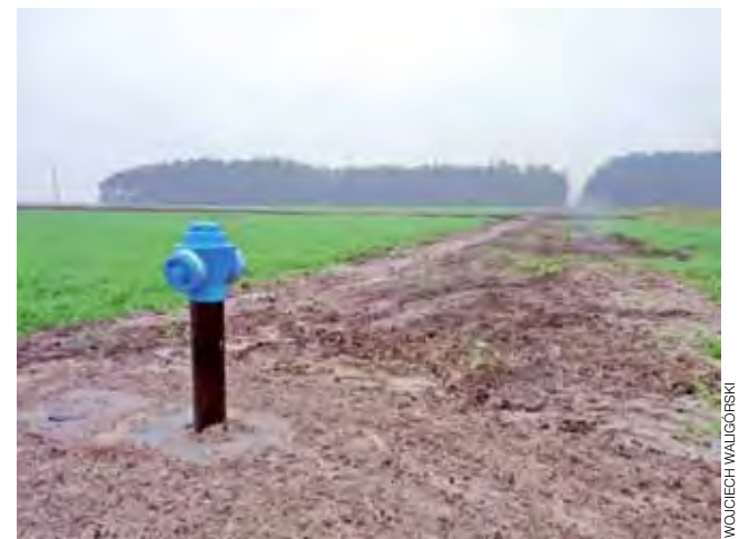
Nowy hydrant przeciwpożarowy w okolicach Pilaszkowa.
