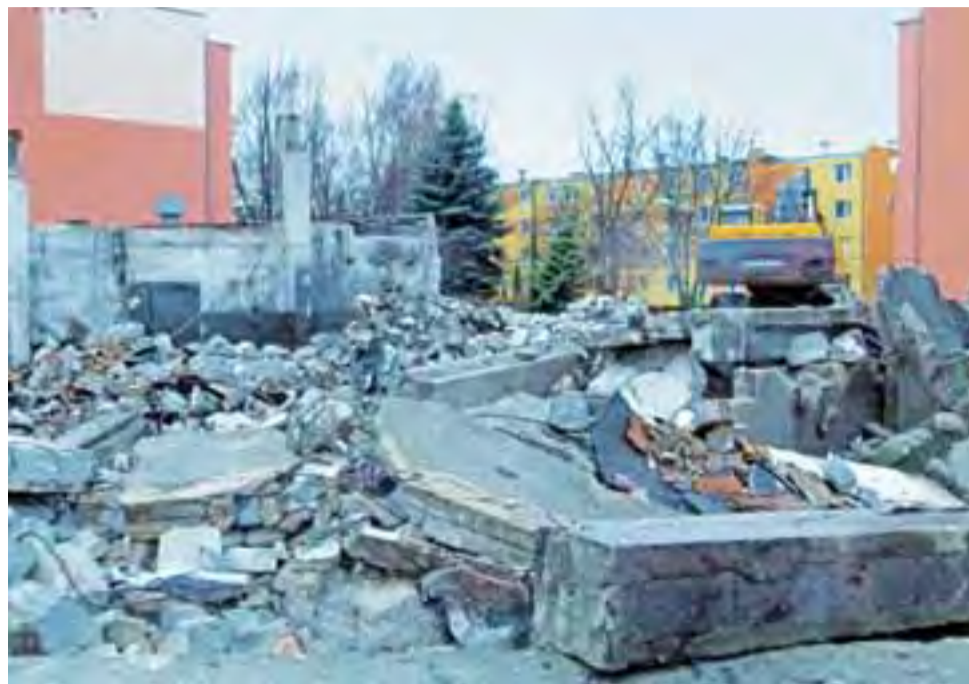
W ciągu jednego dnia z kotłowni przy bloku nr 15 na Bratkowicach zostało gruzowisko.
