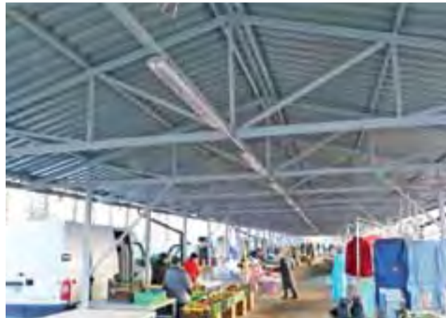
Targowisko gminne w Łyszkowicach. Lampy zawieszono na konstrukcjach utrzymujących dachy.
