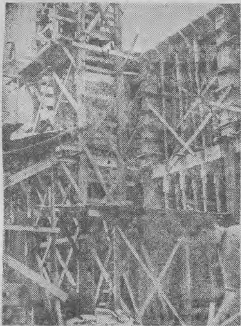
„Elektrobudowa” rośnie. W tym roku fabryka powiększy się o 20 tysięcy metrów sześć.
