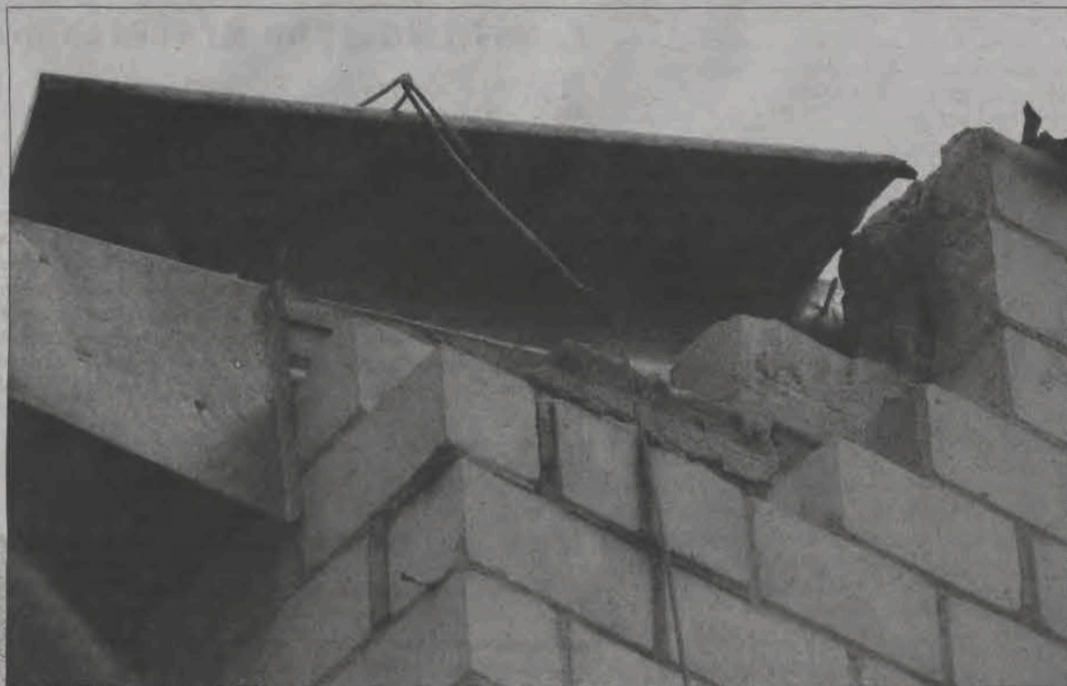
Tak wygląda murek, który ZGM naprawia od ponad pół roku.
