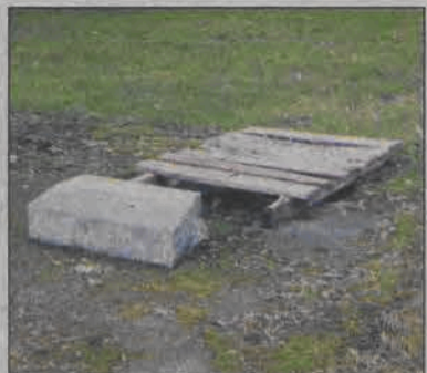
O mizernym zabezpieczeniu studzienki kanalizacyjnej poinformował nas czytelnik.
