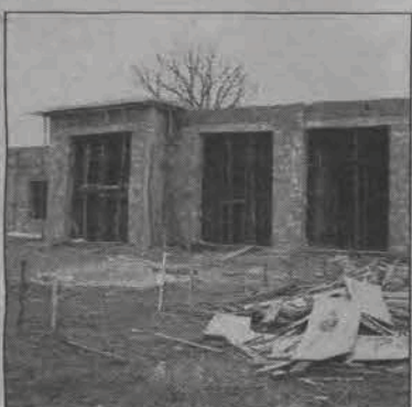
Zniszczenie fragmentu stropu budynku nie było katastrofą budowlaną.
