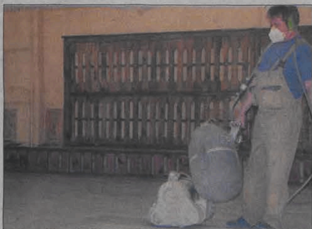
Poprzednio wycyklinowano źle i użyto złego lakieru. Teraz trzeba poprawić.
