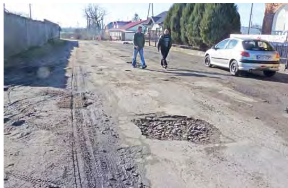
Ciężkie samochody rozjeżdżają drogę powiatową Świechów-Jastrzębia. W wielu miejscach pojawiły się niebezpieczne dziury, a powierzchnia drogi jest cała popękana
