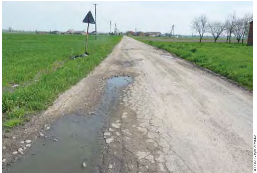
Jeśli w ciągu najbliższych 2 lat nie będzie remontu drogi gminnej Skrzyszewy-Raków, droga rozleci się całkowicie, nie będzie już co ratować.
