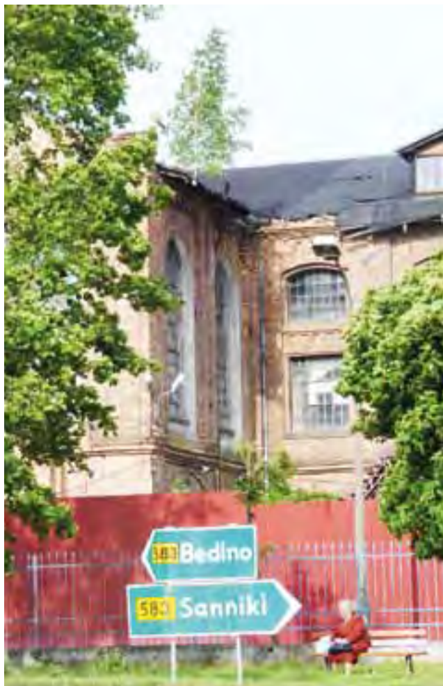
Na dachu niszczonego budynku Emitu wyrosła już okazała brzoza.
