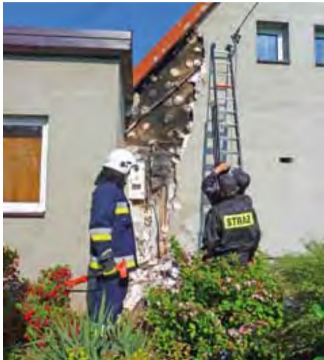
W miejscowości Grabie koło Żychlina paliła się instalacja elektryczna. Część docieplenia domu poszła z dymem.
