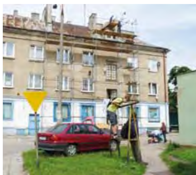
Budomat z Żychlina naprawia trzy kominy na budynku Narutowicza 85f, które po zimie bardzo się zniszczyły i zagrażały bezpieczeństwu.
