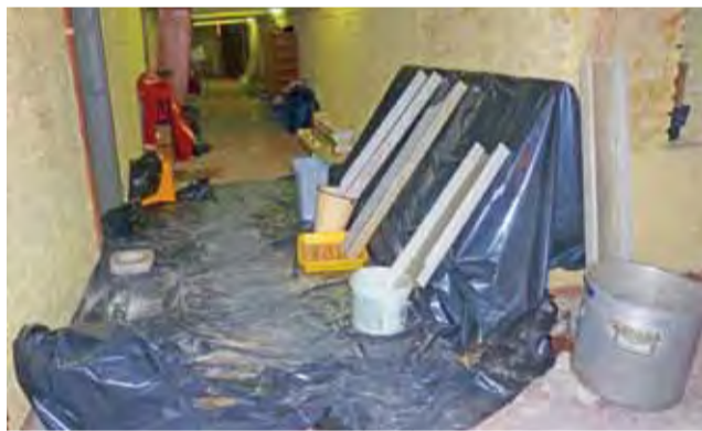
Na strychu Żychlińskiego Domu Kultury porozkładano folie, podstawiano miski i wiadra, by woda z przeciekającego dachu nie zalewała innych pomieszczeń.
