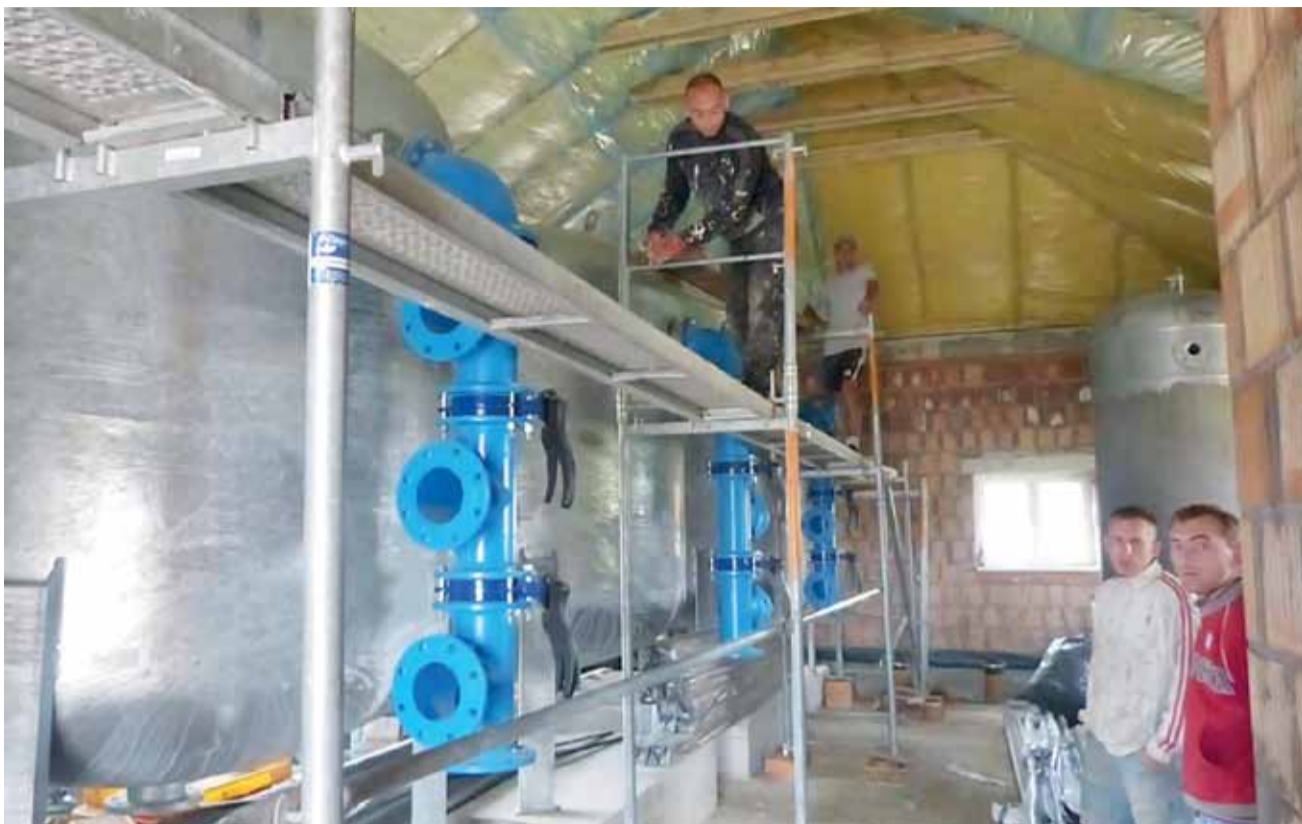
W budynku stacji w Kocierzewie Płd. trwają prace przy podbitce dachu. Jak widać, w środku są już zbiorniki do uzdatniania wody.
