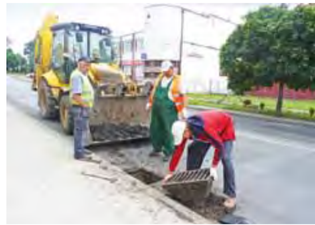
Pracownicy Zarządu Dróg Wojewódzkich, oddział w Łowiczu, czyszczą studzienki kanalizacji deszczowej znajdującej się w ulicy Narutowicza.
