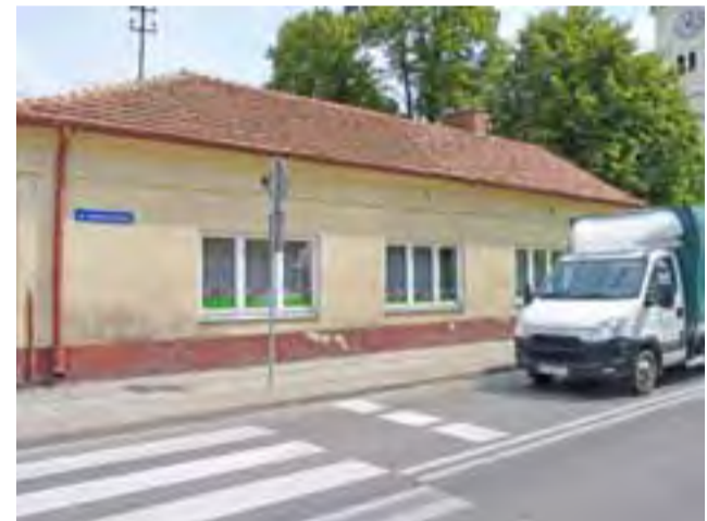
Przedszkole w Bolimowie wymaga gruntownego remontu, zmiana dachu jest jednak na razie priorytetem.
