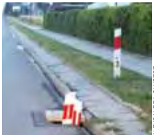
Niebezpieczna niespodzianka dla użytkowników drogi – dobrze chociaż, że oznaczona słupkiem.
