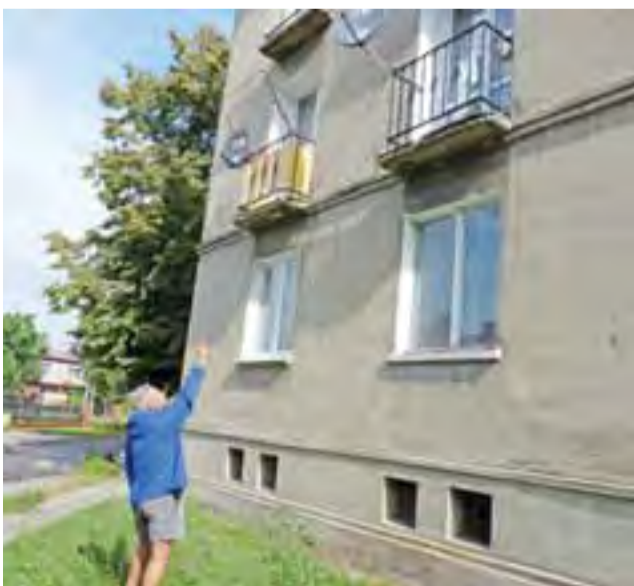
Sypią się balkony w bloku przy Mickiewicza 2.
