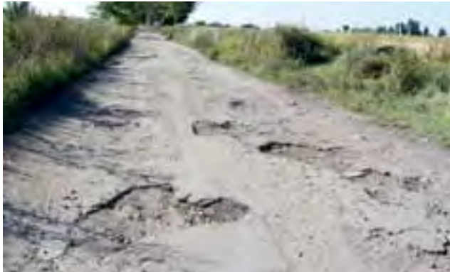
Z asfaltowej drogi powiatowej z Gołędzkiego do Poborza niewiele zostało. Droga jest dziurawa jak ser szwajcarski, trudno nią przejechać.
