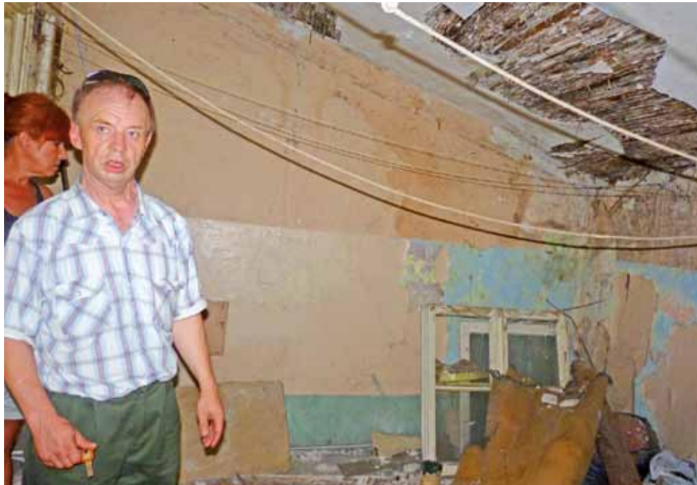
Lokatorzy „porodówki” pokazują, jak wygląda poddasze budynku, gdzie jest suszarnia. Tynk trzciniowy odpada płachtami, a woda leje się po ścianach
