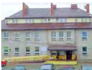
Dach na ośrodku zdrowia został wymieniony późną jesienią ubiegłego roku. Kiedy budynek doczeka się docieplenia, nie wiadomo.
