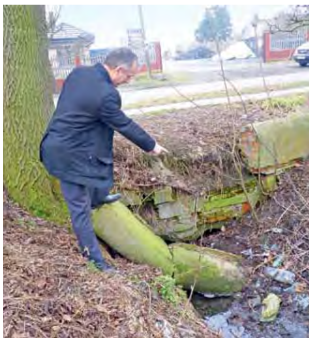
Prezes nowej Spółki Wodnej Ziemi Żychlińskiej, Marek Materka , zgłosił do starostwa awarię na ulicy Żeromskiego. Przepust pod drogą powiatową jest zarwany i nie odprowadza wody z rowu melioracyjnego.
