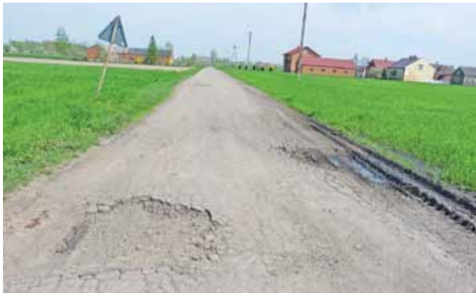
Droga do Rakowa czeka na remont. Urząd Gminy w Pacynie złożył wniosek na dofinansowanie remontu ok. 1000 m do Urzędu Marszałkowskiego w Warszawie w ramach WFOGR.
