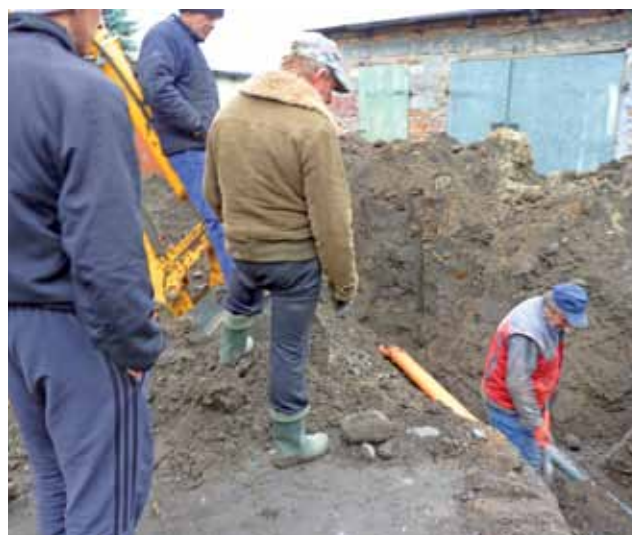
Samorządowy Zakład Budżetowy kończy podłączanie wody i ścieków do kamienicy przy ulicy Narutowicza 53. Mieszkańcy chętnie przyglądają się postępowi prac.
