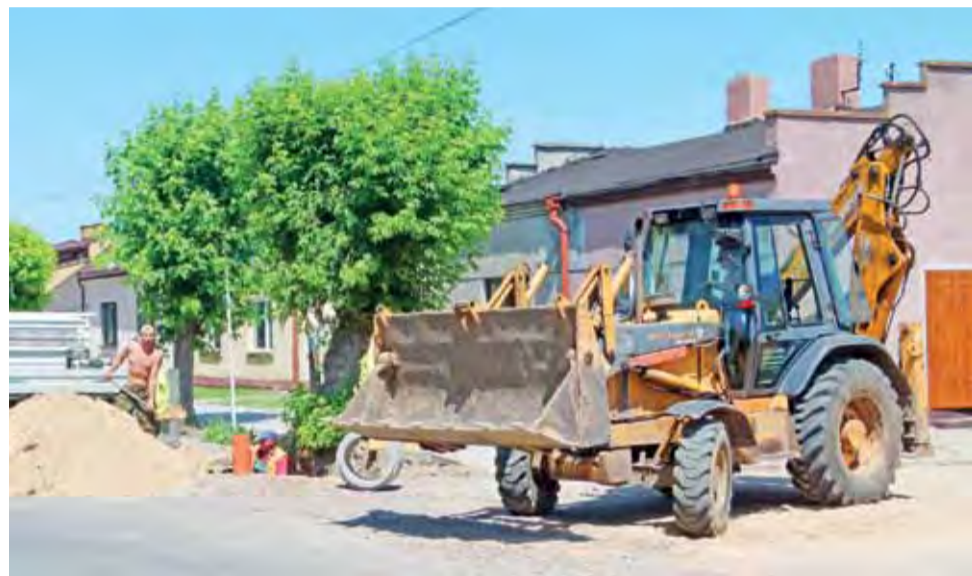
Zakończone już roboty kanalizacyjne przy ul. Wolskiej, o których na sesji mówił radny Grochocki.
